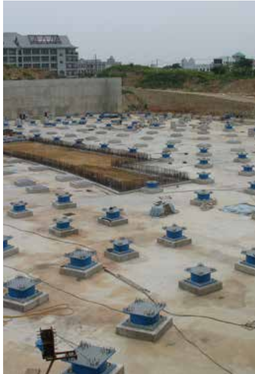
Aisladores sísmicos basales en la construcción del Hospital Tan Tzu, Japón.
